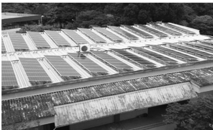
Figura 4 – Sistema fotovoltaico On Grid
